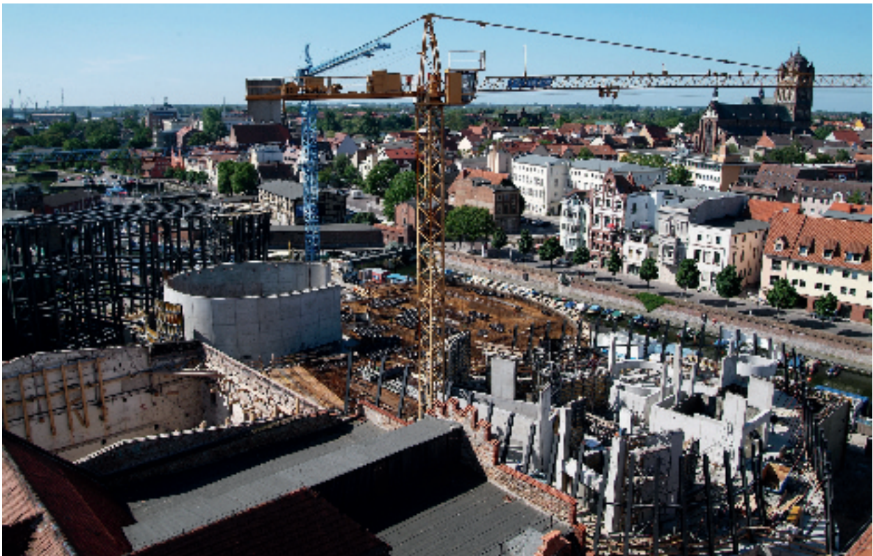
Abb. 1: Im Frühjahr begann der Rohbau des OZEANEUMs endlich aus dem Boden empor zu wachsen, hier im Mai 2007.
