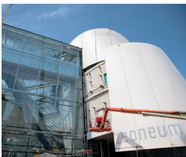
Abb. 27: Die Verglasung des Foyers dauerte bis zum Schluss an. An Schnittstellen mussten sich Gewerke besonders intensiv abstimmen.
