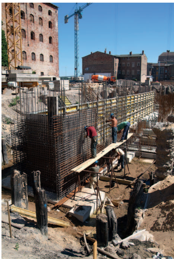
Abb. 4: Die ersten Kellerwände werden geschalt. Teile der Gründung sind bereits fertig gestellt. Im Vordergrund befinden sich noch Reste der mittelalterlichen Hafenanlage.
