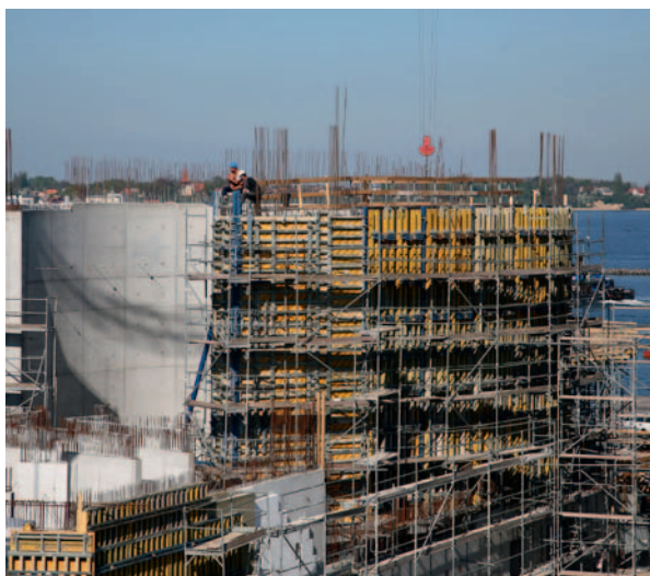
Abb. 12: Der Bau des großen Schwarmfischbeckens erfolgte in Abschnitten. Die Öffnungen für die Scheiben müssen exakt geschalt und betoniert werden.
