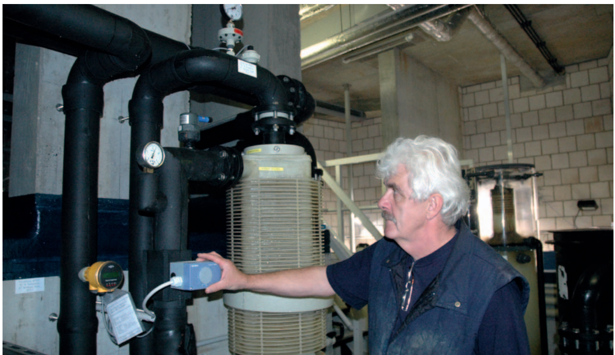
Abb. 4: Rolf Wilsch überprüft eine Einstellung an einem Kreislauf.
