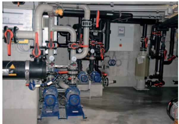
Abb. 1: Die Technik hinter den Becken ist sehr komplex.
