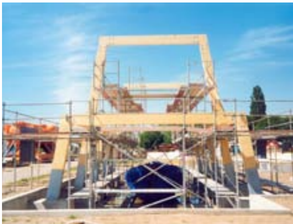
Abb. 14: Nachdem das Fundament der neuen Bootshalle fertig war, wurde das Zeesboot STR 9 in die Ausstellungs- fläche gestellt und erst dann die ungewöhnliche Dachkons- truktion errichtet (2001).
